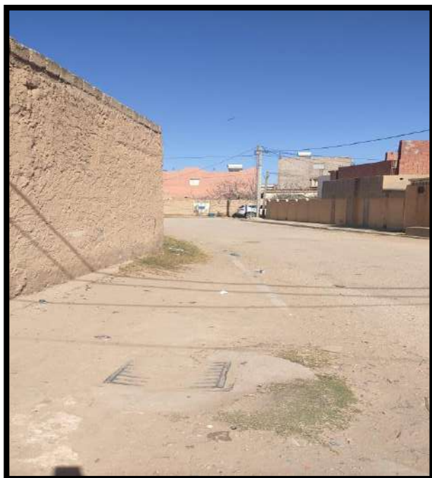
Figure 10: Réseau de drainage colmaté
