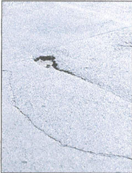
Fissuration anarchique + nid poule
