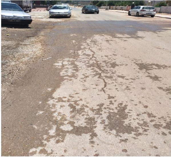
V1 : Chaussée peu dégradée
