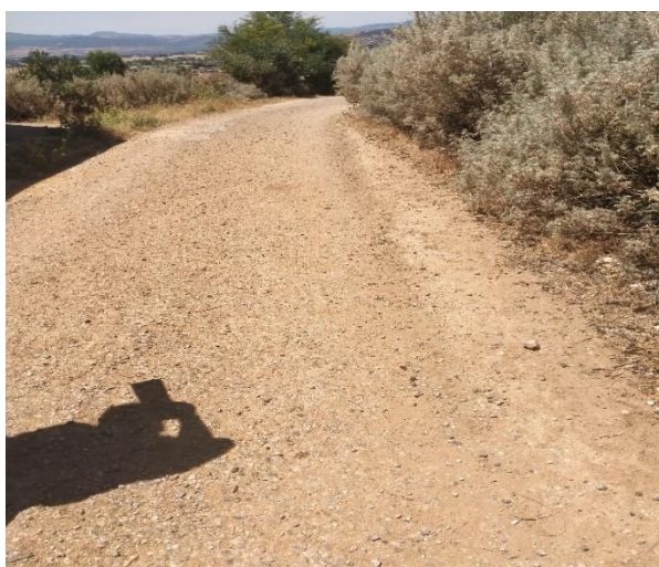
V4 : Chaussée très dégradée
