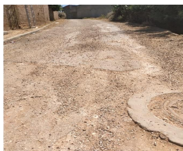
V8 : Chaussée très dégradée
