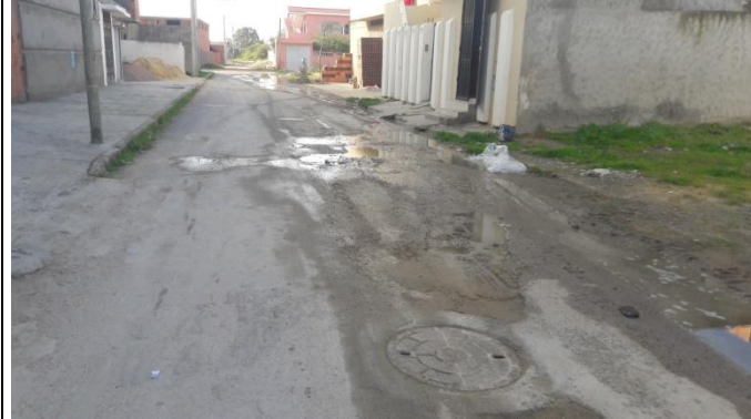
Photo n°27: Eaux stagnées sur la voie n°01 du côté rue Dougga.
