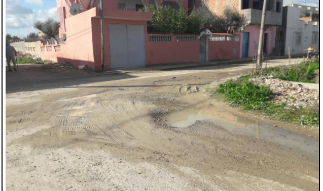
Photo n°28 : Vue de l'intersection Voie 01 et la Voie 2.1 et 2.2 (stagnation des eaux de pluies)
