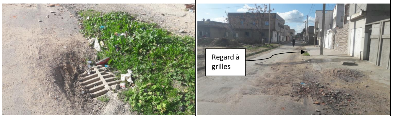
Photo n°37 et 38 Voie n°2.1, rue avec réseau de drainage non fonctionnel
