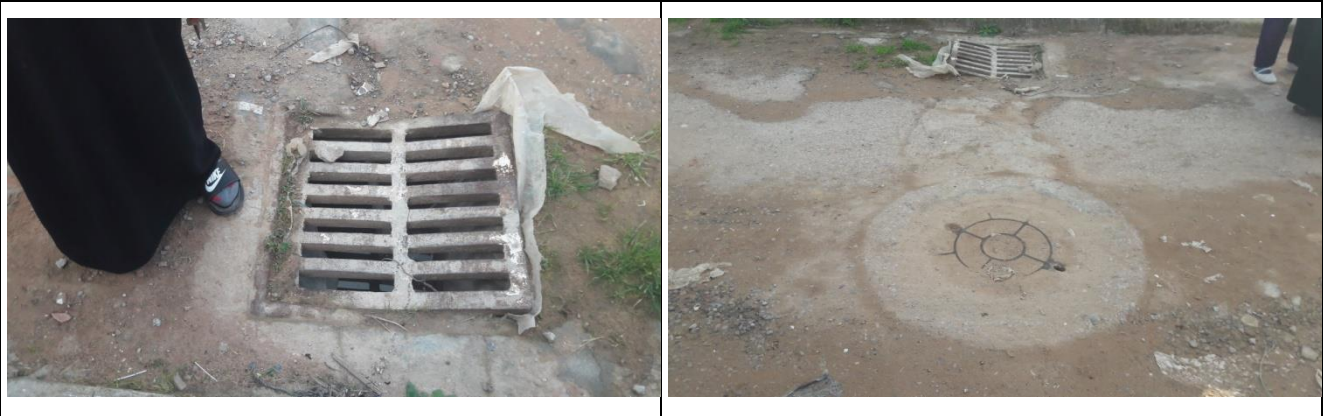
Photo n°35 et 36: Voie n°3.1, rue avec réseau de drainage non fonctionnel, et regard ONAS au voisinage pose un problème de débordement lors des jours pluvieux.
