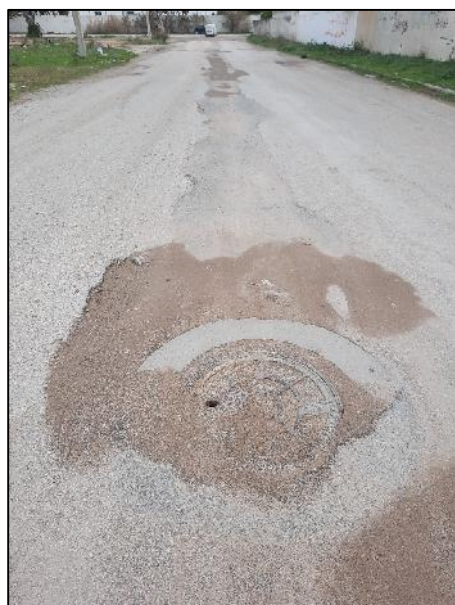
Dégradation de la chaussée au droit des tranchées d'eaux usées
