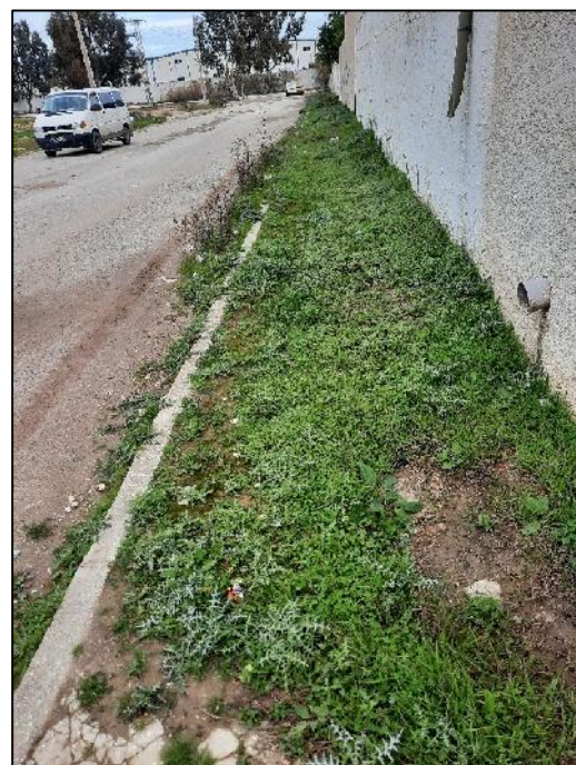
Trottoirs Dégradés - Présence de végétation
