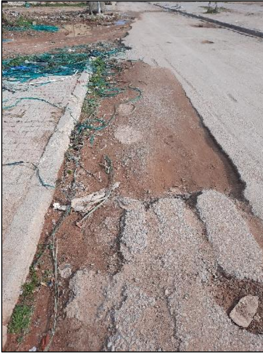
Érosion en rive de la chaussée
