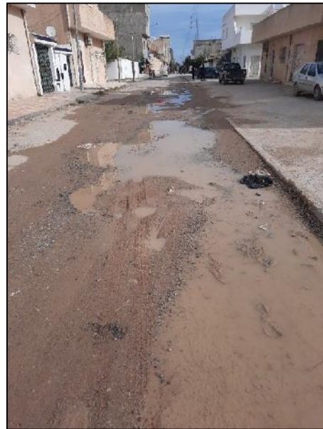
Usure du revêtement
