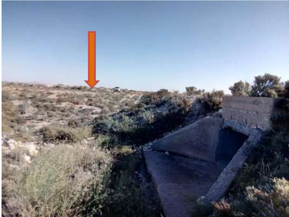
Figure 9: Un bras de l'oued Dardour contourne du côté Nord le terrain acquis pour l'aménagement du marché des bestiaux.
