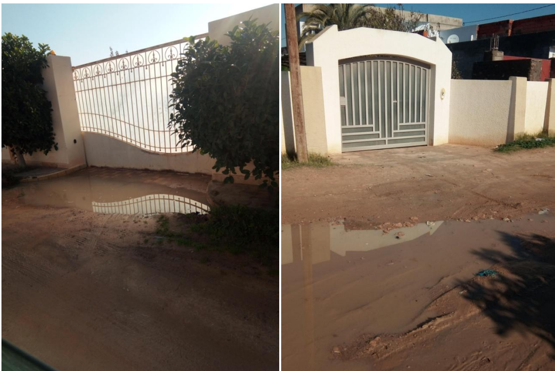
Figure 9 : Des côtes seuils exposées au risque d'intrusion superficielle des eaux de ruissellement
