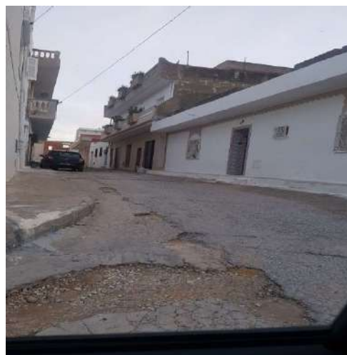
L'axe A13 à l'état bicouche dégradé
