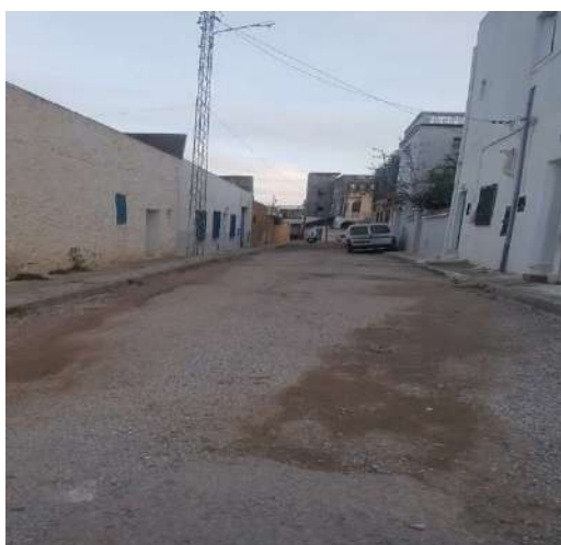
L'axe A11 à l'état bicouche dégradé
