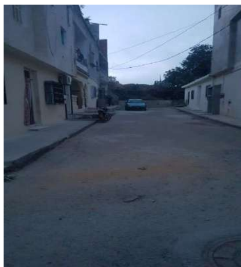
L'axe A46 à l'état bicouche dégradé
