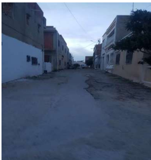
L'axe A38 à l'état bicouche dégradé
