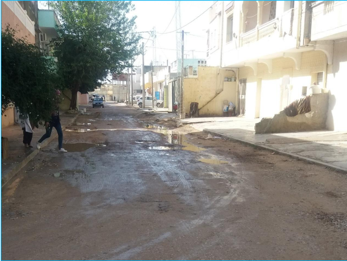
Stagnation importante des eaux pluviales
