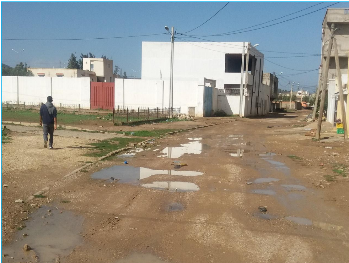
Voie revêtu en bicouche en état dégradé
