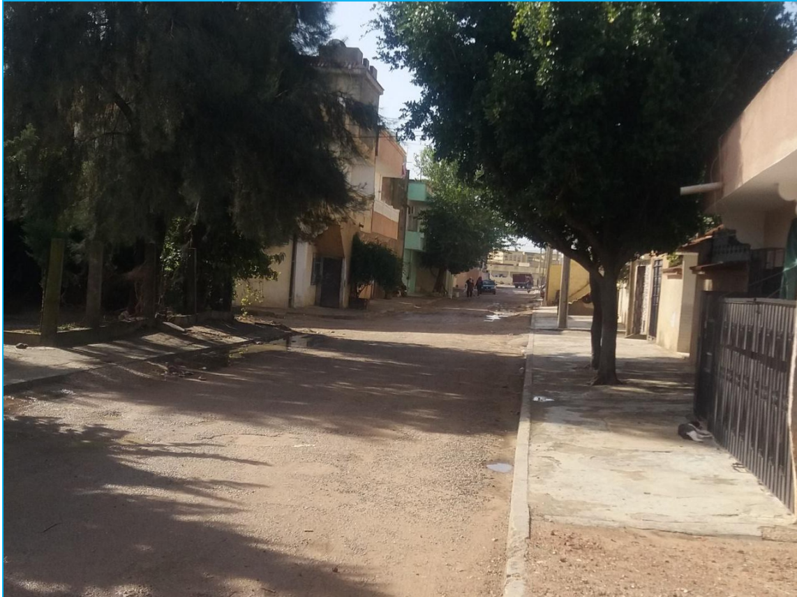
Voie en état dégradé
