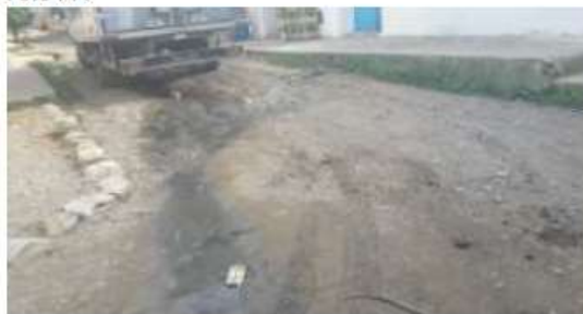
Eaux usées libres
