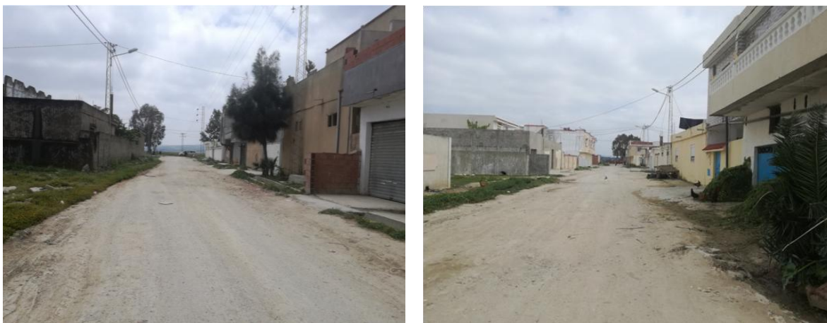
Figure 18: État actuel de la voirie revêtue dans le quartier El Manar
