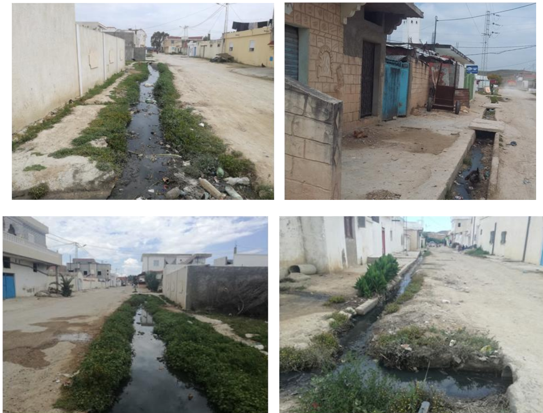
Figure 23 : État actuel des ouvrages de drainage des eaux pluviales dans le quartier El Manar
