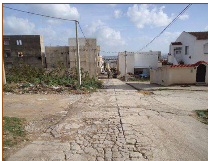
Photo 4 : Voie en béton armé très dégradée.
