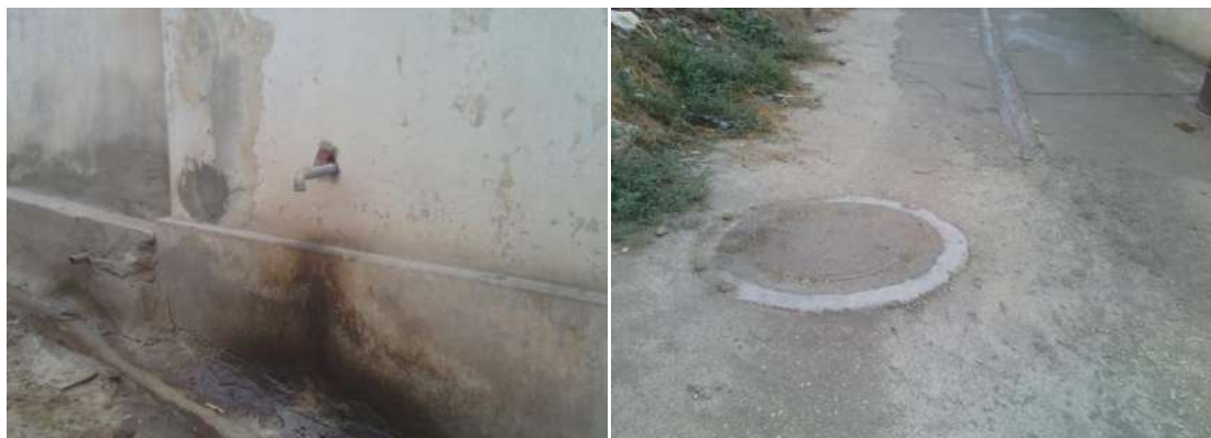
Figure 21 : Rejet des eaux usées dans le quartier ECHOUHADA
