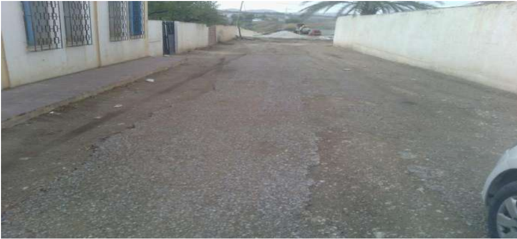
Etat actuel de la chaussée dégradée (voie n°18) et structure morphologique de la rue (emprise régulière) et Occupation du terrain (terrain construit).
