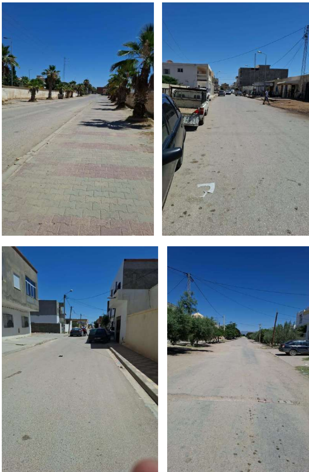
Figure 9: Revêtement dégradé avec présence du nid-de-poule
