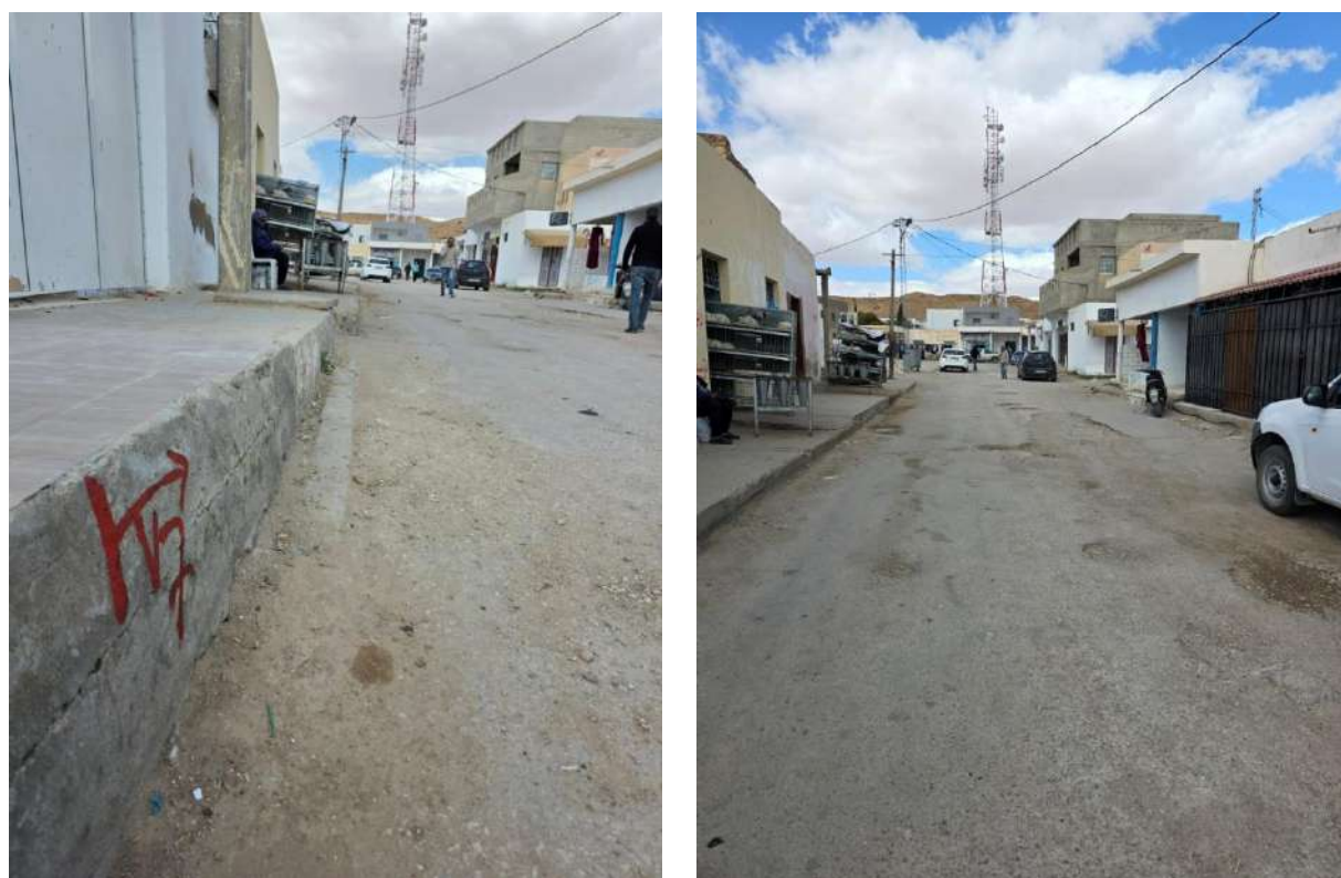
Figure 9: Revêtement dégradé avec présence du nid-de-poule
